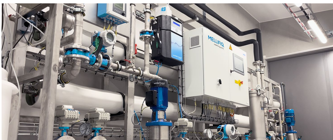
Färdig installation av Water Maid CoraLuxe B2-N system för dricksvatten med permeatflöde upp till 9 m 3 /h.
