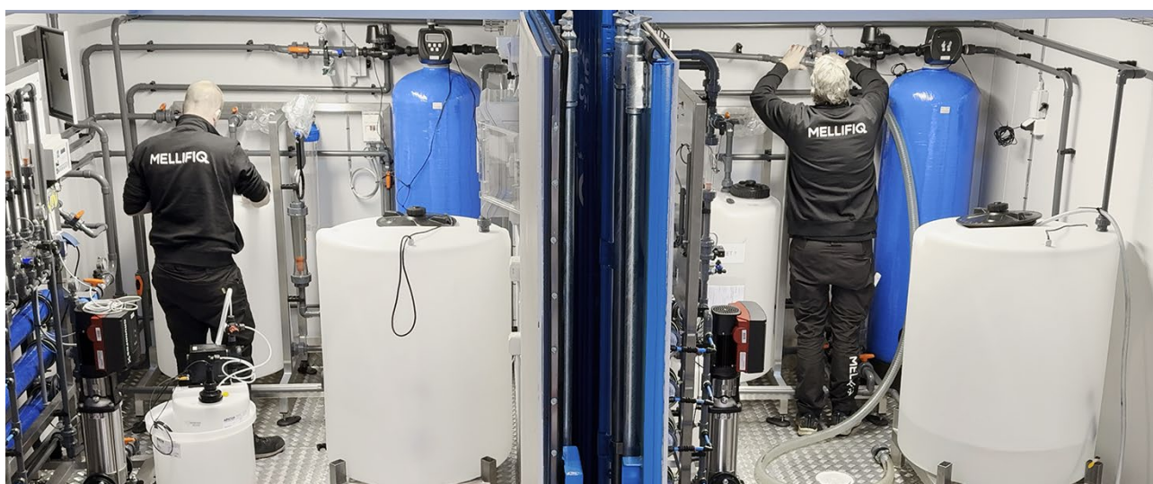
Slutmontering och FAT av Water Maid CoraLuxe AC2-N system för grundvattenrening.
